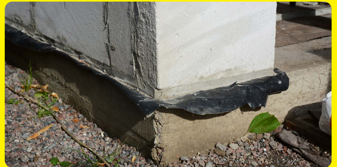
Nevhodná hydroizolácia budovy
