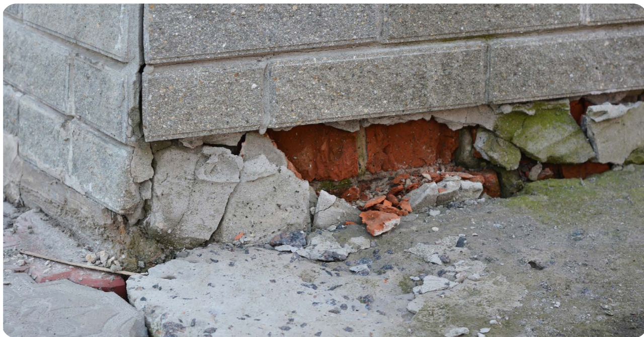
Ukážka poškodenia muriva vlhkosťou
