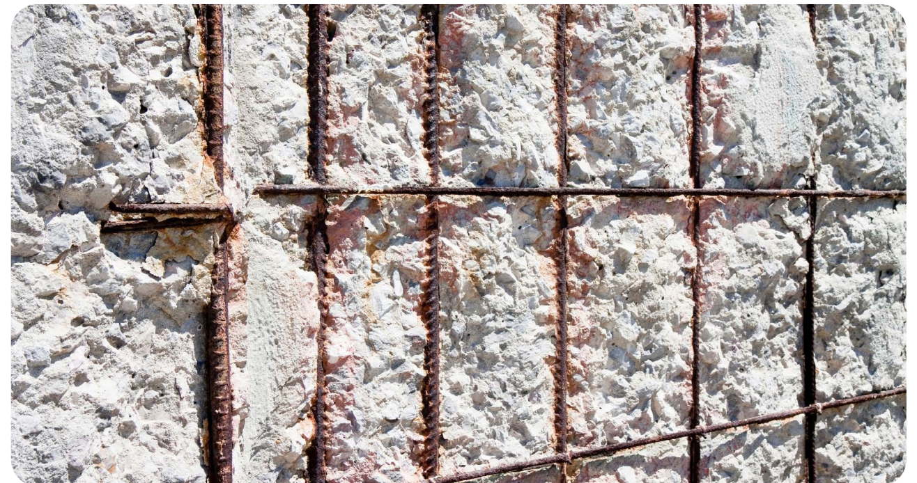
Ukážka poškodenej výstuže železobetónovej konštrukcie
