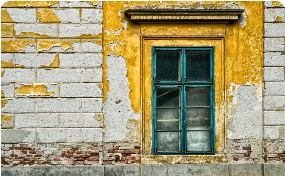
Ukážka poškodenia muriva vlhkosťou
