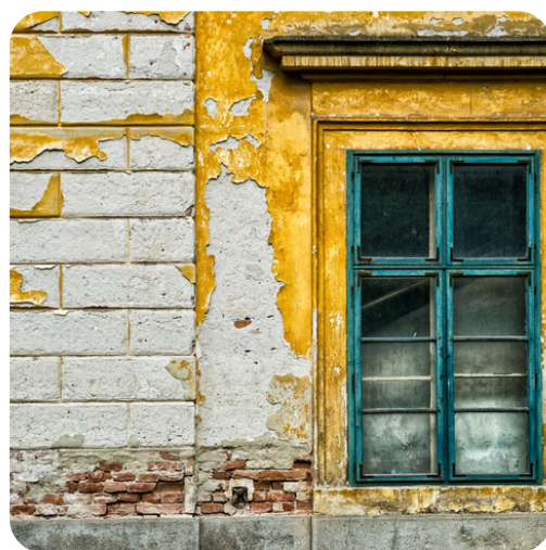
Ukážka poškodenia muriva vlhkosťou
