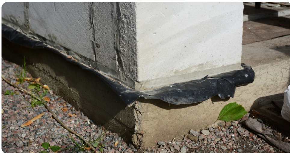
Nevhodná hydroizolácia budovy
