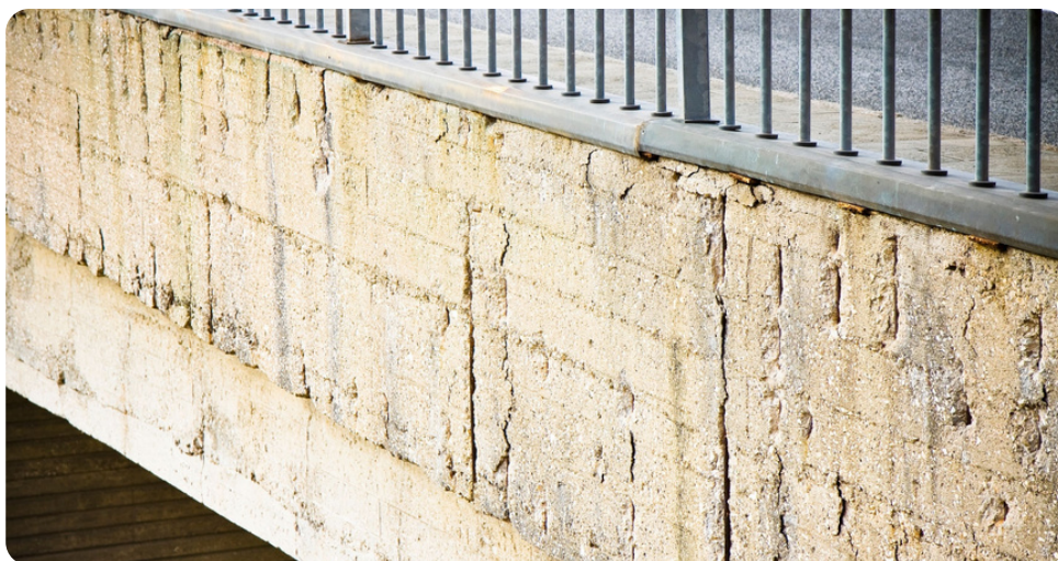
Poškodená mostná konštrukcia
