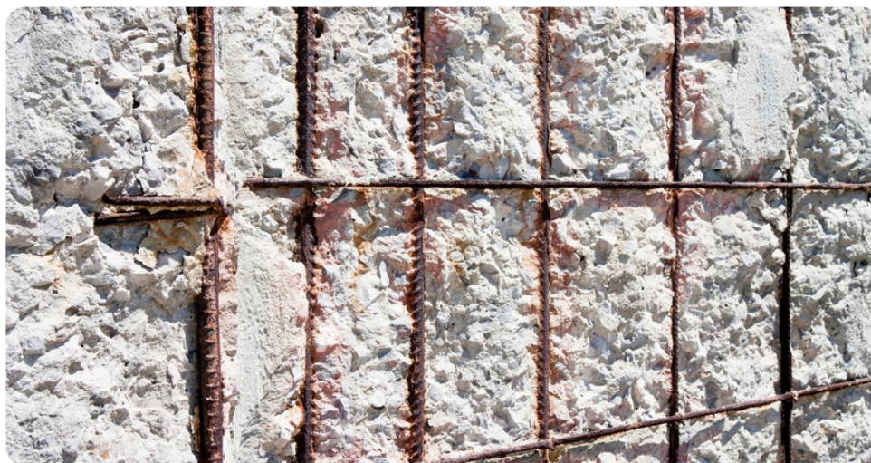
Ukážka poškodenej výstuže železobetónovej konštrukcie
