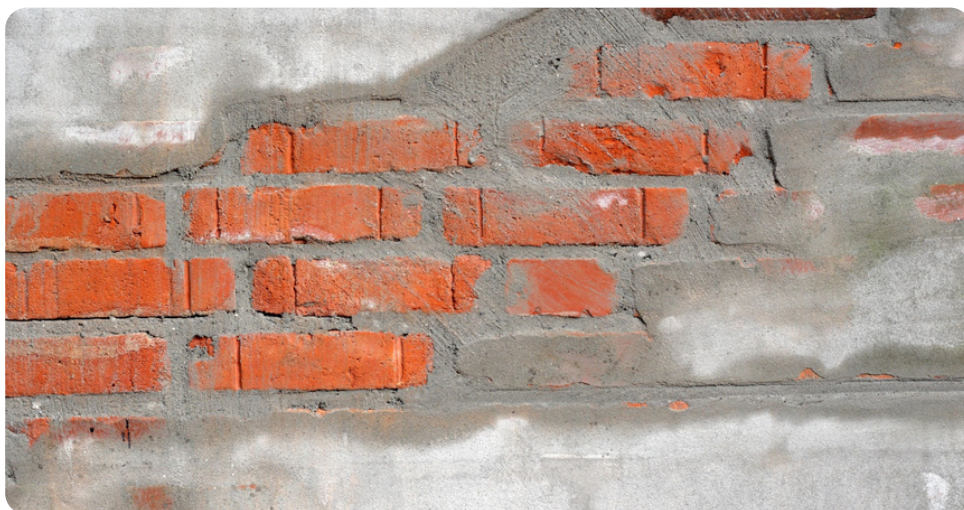
Podklad zaťažený vlhkosťou
