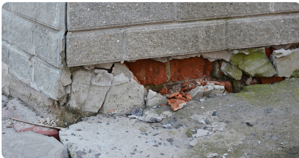
Ukážka poškodenia muriva vlhkosťou
