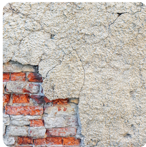
Nevhodný podklad pre aplikáciu
